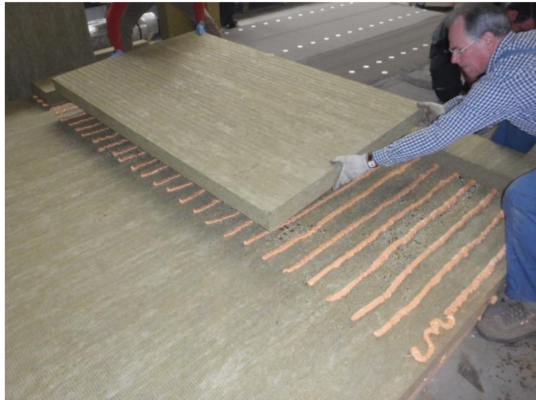
Foto 7 Die Wärmedämmung (obere Schicht) wird auf die untere Schicht der Wärmedämmung angebracht.
